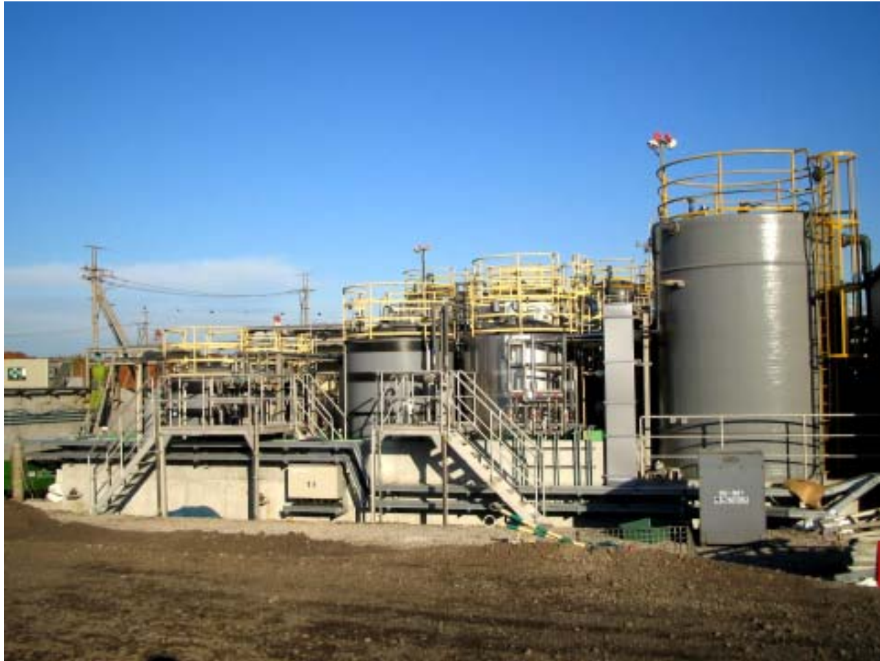
シアン水処理設備全景
