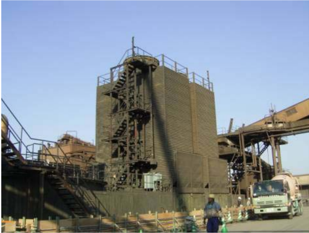
改善前の冷却塔(開放型直接冷却方式)
